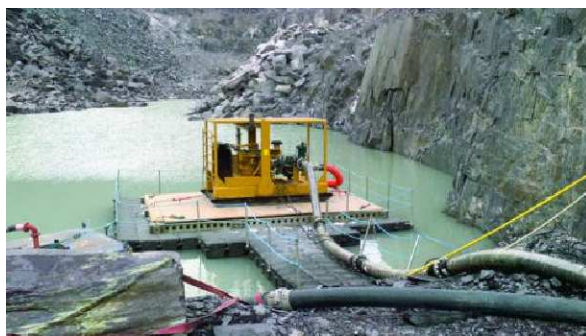
Sl.1 Pontonski dizel pumpni agregat za zaštitu površinskog kopa od atmosferskih voda
